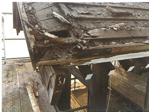
解体工事前の予想以上に屋根は傷んでいた
